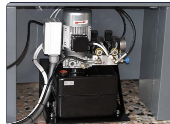
La centralina idraulica
